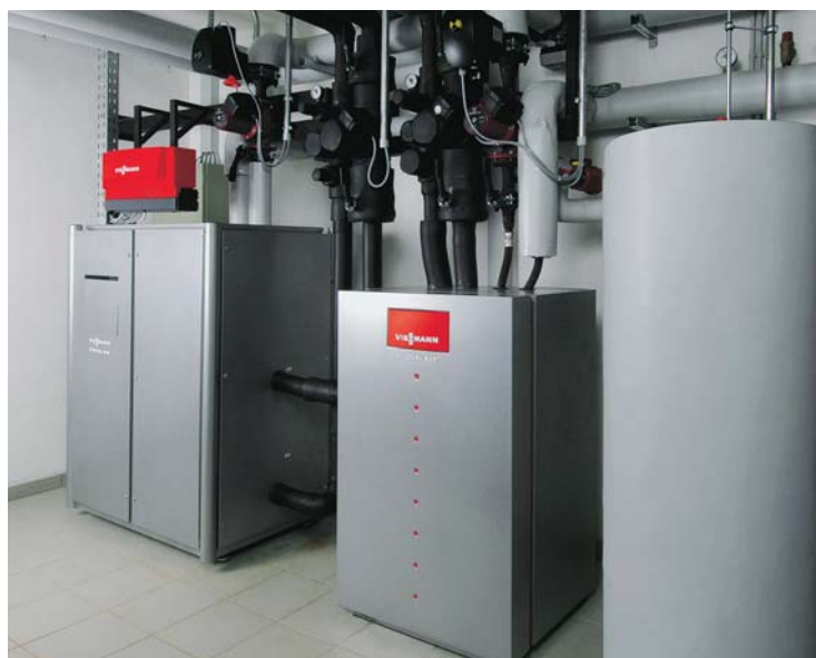
Bild 3 • Die Heizungsanlage besteht aus zwei Viessmann Vitocal 300 Wärmepumpen, die für Wärme sowohl in der Kirche als auch im Gemeindezentrum sorgen.
